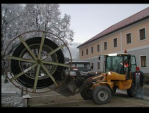
LWL Datenleitung in Großschönau
